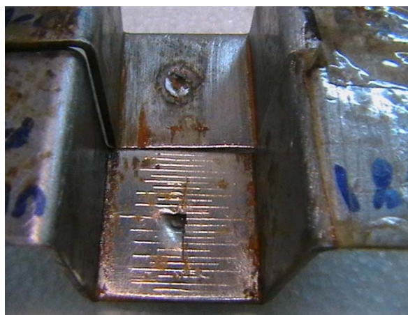
شکل ۷ نحوه رشد ترک در ورقهای با ضخامت ۱/۵ میلیمتر
