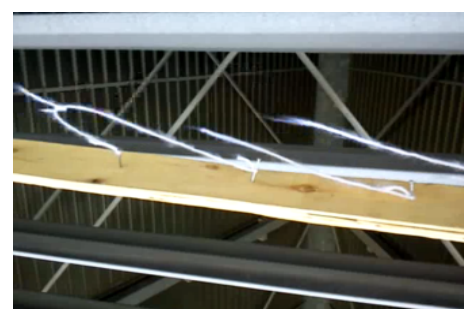
شکل ۱۷ الگوی جریان هوا در محل ۲ دلتای نامناسب
