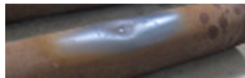
شکل 1 نمونه ای از فرورفتگی در لوله
