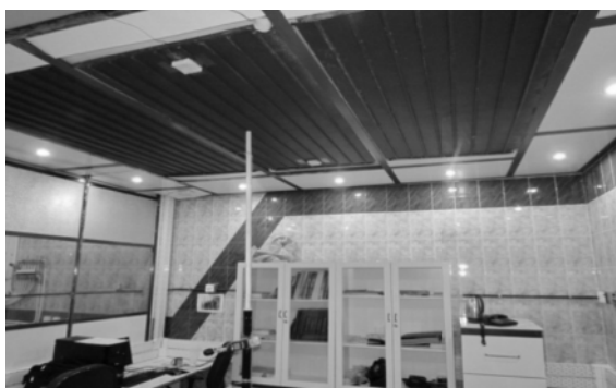
شکل ۲ نمونه‌ای از پانل سرمایش تابشی سقفی نصب شده در آزمایشگاه مهندسی حرارتی دانشگاه تربیت مدرس
