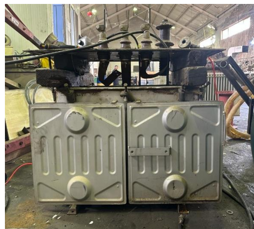
شکل ۱) نمایی از ترانسفورماتور توزیع برق مورد آزمایش
