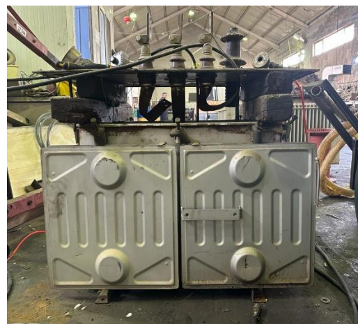
شکل ۱) نمایی از ترانسفورماتور توزیع برق مورد آزمایش
